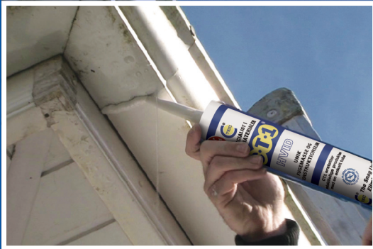
Hurtig reparation af lækkende afløb
